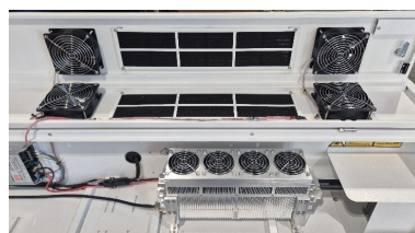
Ventilationsgaller i locket till laserkällan (öppet)
